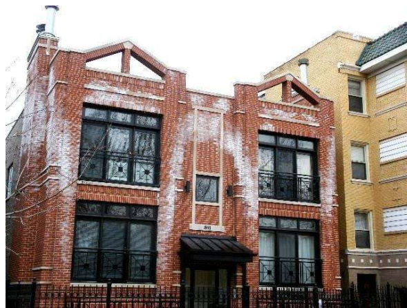
Figure 4- 4 : L'efflorescence sur la façade d'un bâtiment (site : https://www.avantage-plus.com/ ).
